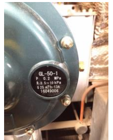
LNG用圧力調節計⇒
