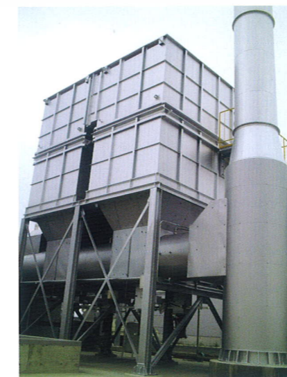
蓄熱式脱臭装置 (RTO)
